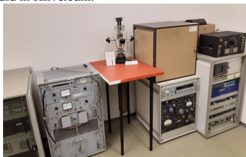
De zendbuis in onze opslag in het zendgebouw
