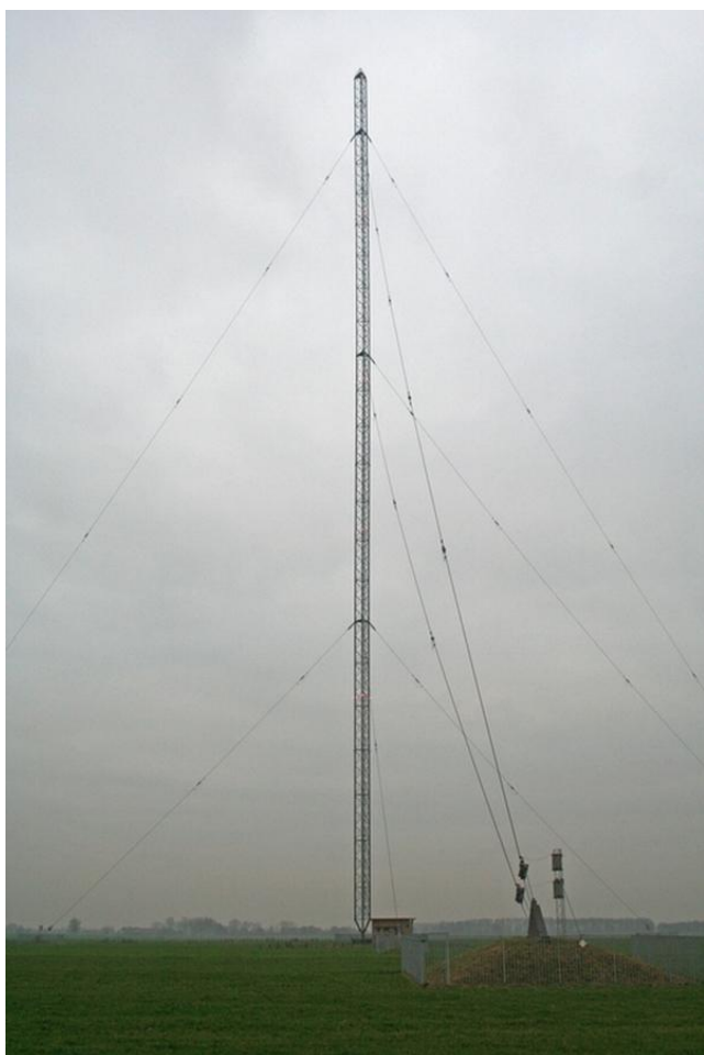
De 2e tui van boven (links) op de foto is weg. Daardoor buigt de top van de mast naar links.
